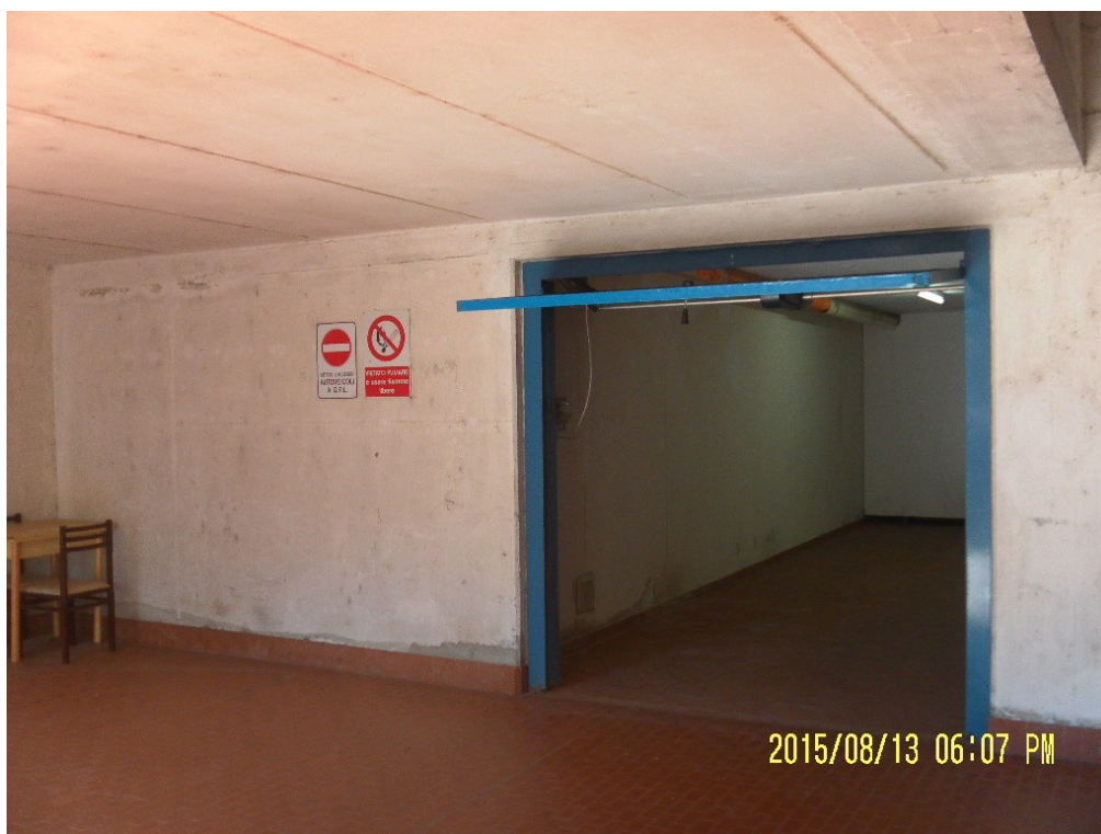
Basculante dell'autorimessa aperto con telecomando FAAC
